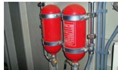
Redundanter Aufbau einer Brandbekämpfung als Zweischussanlage.
